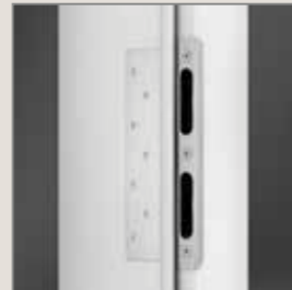
Das Sicherheitsschließblech ist fest mit dem Türfutter und der Mauer verschraubt.
